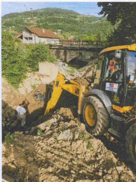
Slika: Sanacija kvara na glavnom distributivnog cjevovoda u naselju Rakonje – Pavića potok – ACC DN 300mm, dubina preko 10 metara
