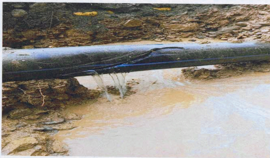
Slike: Sanacija vodovoda HDPE DN 200mm vodovoda Zaton nakon oštećenja od strane izvođača radova na rekonstrukciji magistralnog puta B.Polje-Berane
